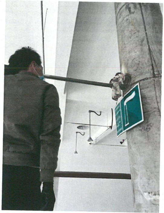
锅炉废气排放口 2# (FQ-21282) G2
