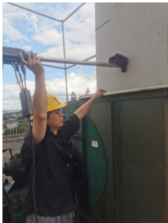
工艺有机废气排气筒出口(FQPK-0004)G4
