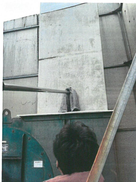
工艺有机废气排气筒出口(FQPK-0004)G4
